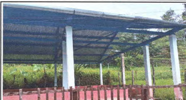
Foto 2: El cambio de estructura se realizara por deterioro en estructura de madera
